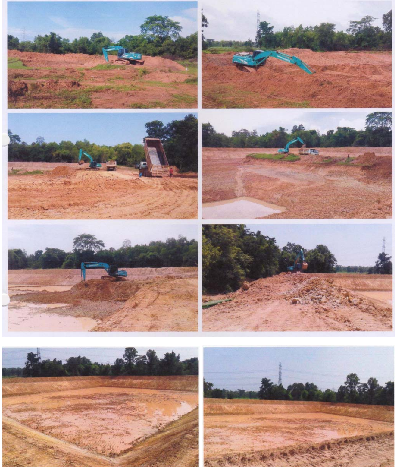
รูปภาพขณะดำเนินงานโครงการขุดลอกสระเก็บน้ำบ้านห้วยยาง หมู่ที่ 12
